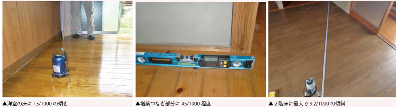
▲洋室の床に13/1000の傾き
