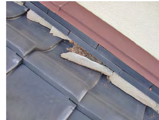
▲面戸モルタルの割れ
