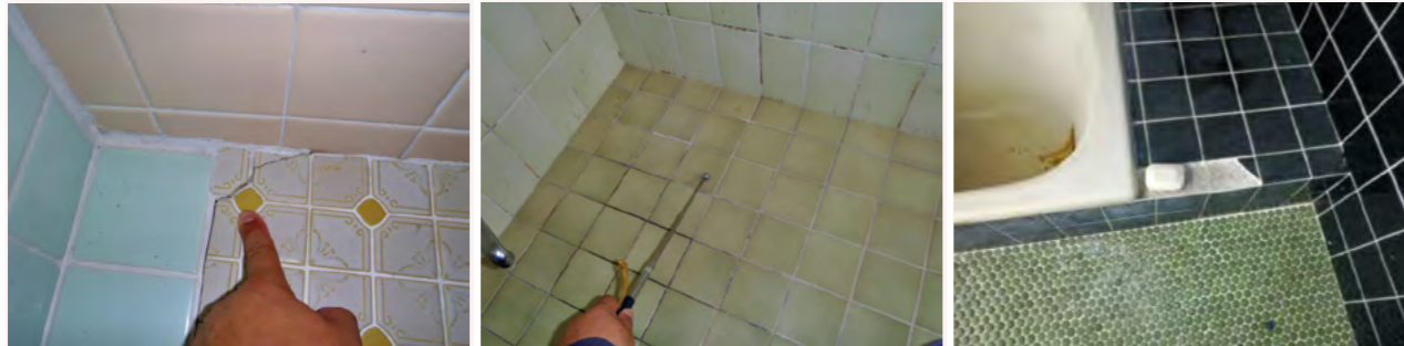
▲床タイルの割れ
