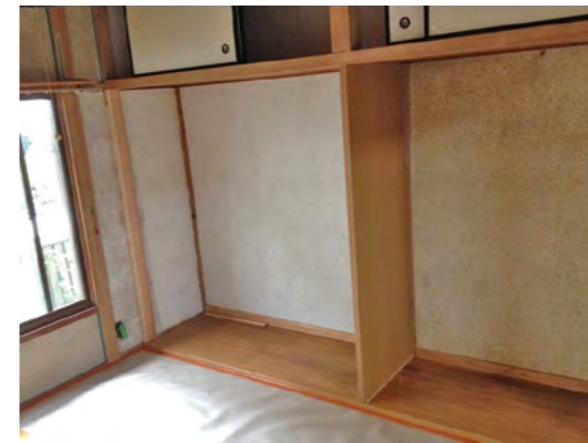
▲既存じゅうらく塗り部分の剥離
