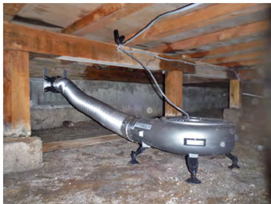
▲機械換気設備設置事例
