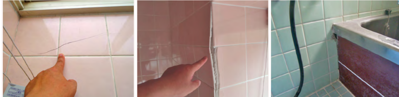
▲壁タイルの割れ
